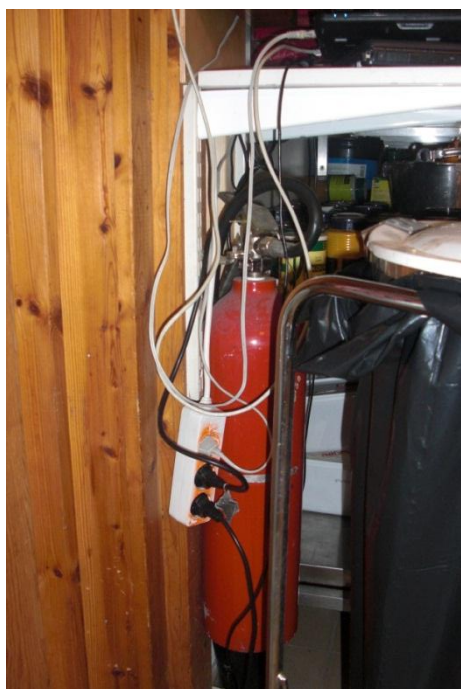
Figur 11. Blockerad brandsläckare. (Edström, E, 2012)
