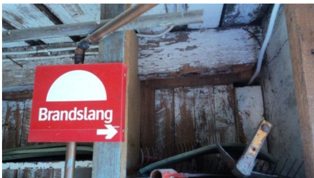
Figur 15. Hylla för brandslang som är tom i förrådet. (Edström, 2012)
