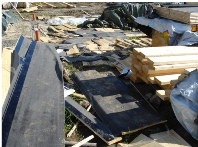
Figur 4.8: Spill på byggarbetsplatsen.
