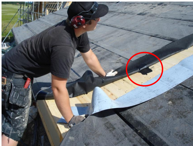
Figur 4.7: Skadad papp på grund av för stark limning.
