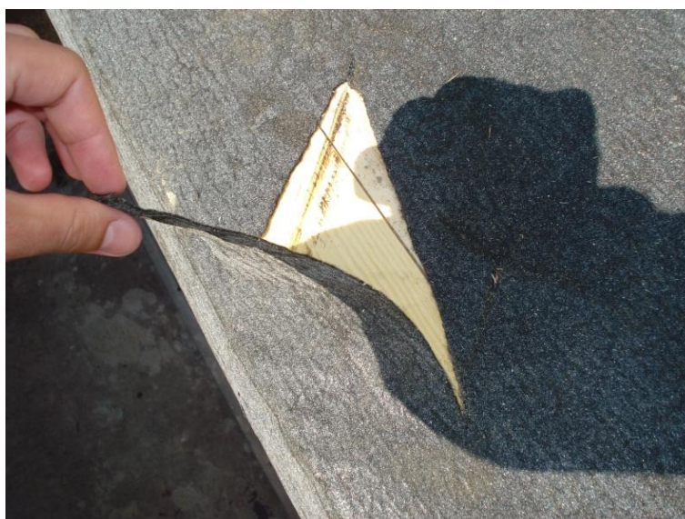
Figur 4.6: Skadad papp på en monterad lucka.
