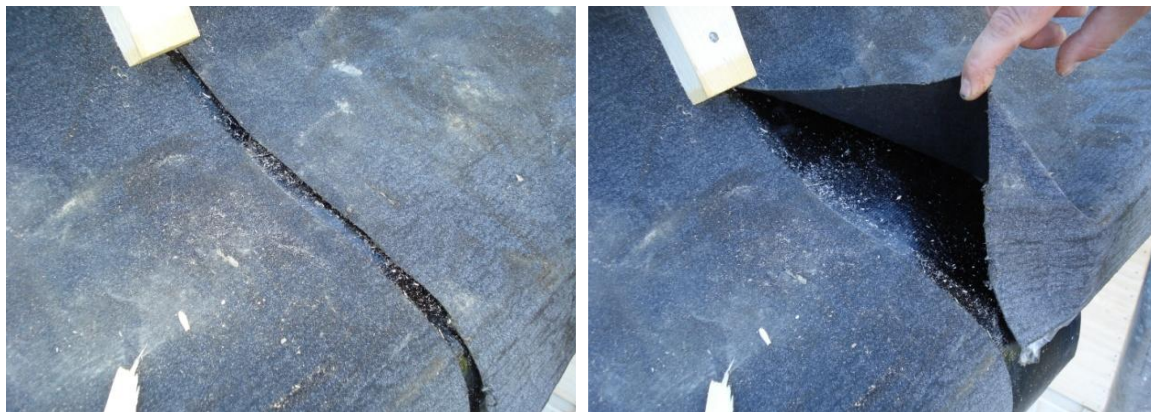
Figur 4.9: Bristfällig fästning i generalskarven på grund av inträngning av sågspån.
