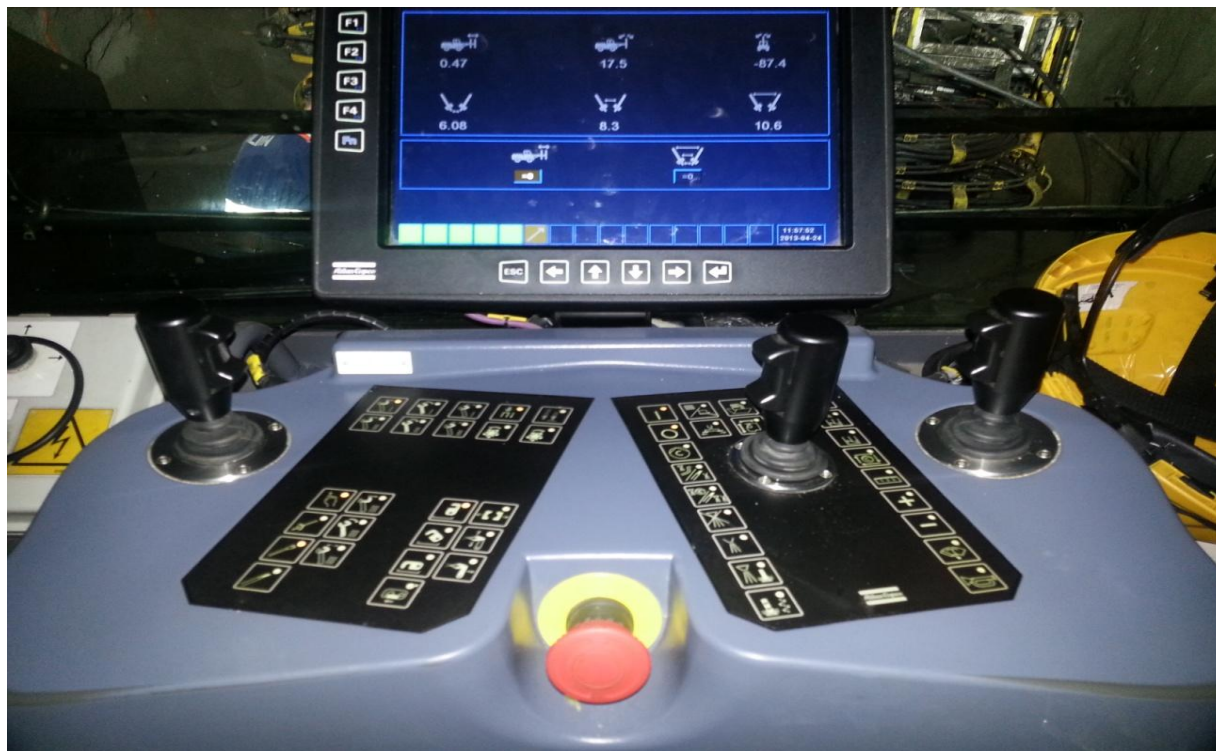
4. Kontrollpanel och RCS i Boltecen. Härifrån styrs bommen, borrningen och bultsättningen. Foto: R.Forsell
