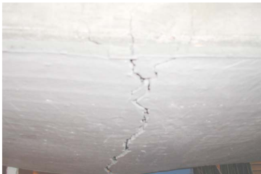
Bild A7. Spricka i polymerbetongen som gav upphov till fiberbrott, platta 6.
