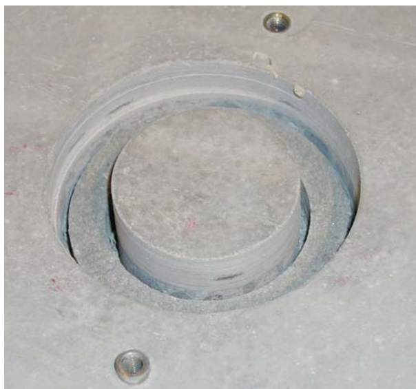
Bild 11.1. Platta 2 efter torq-test, vidhäftningsbrott har uppstått mellan polymerbetongen och plattan.
