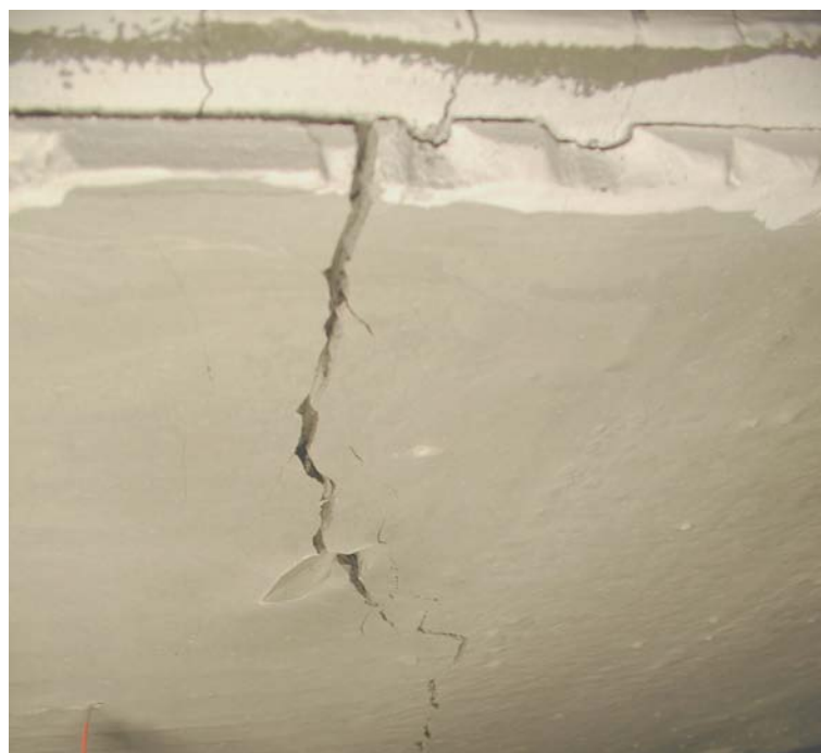
Bild A3. Spricka i polymerbetongen där fiberbrott inträffat, platta 2.
