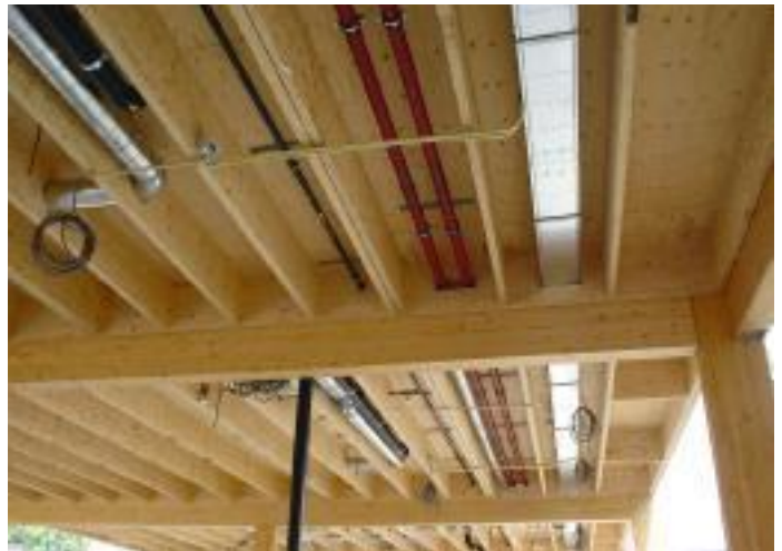
Utrymme för installationer kan göras i bjälklagen. En annan lösning är ett nedpendlat undertak. Foto: Moelven
