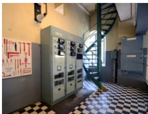
Bild 6. Den nyare kontrollutrustningen, intill spiraltrappan som leder upp till högspänningsställverket.
