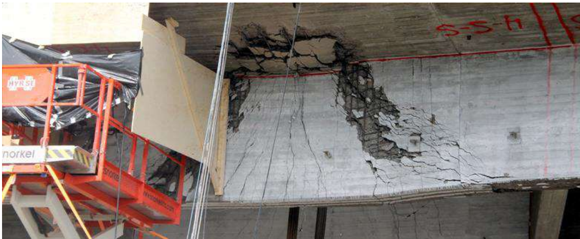
Figur 5.1: Segt böjskjuvbrott i den södra huvudbalken, Bagge (2014).
