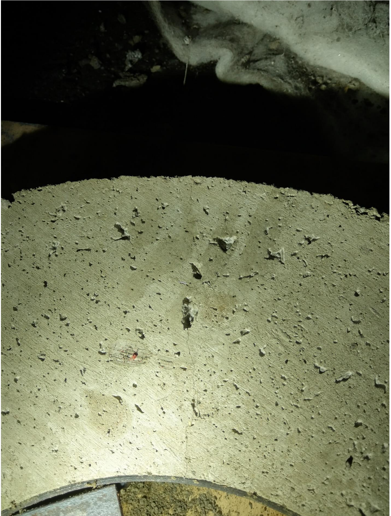
Figur 7 Krymspricka i gjuten betong icke vattenhårdad.
